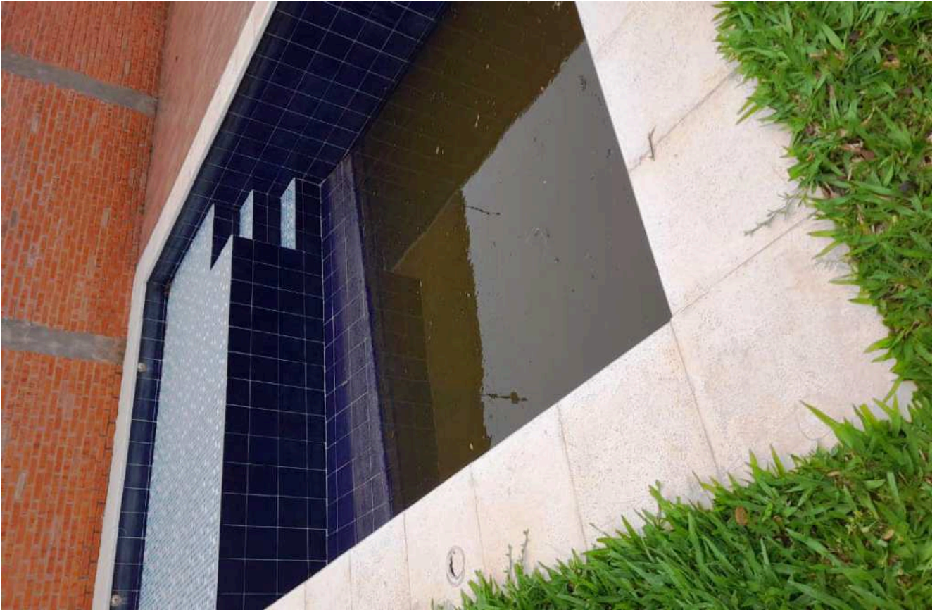
Piscina abandonada que sirve de criadero de mosquitos y alimañas.
