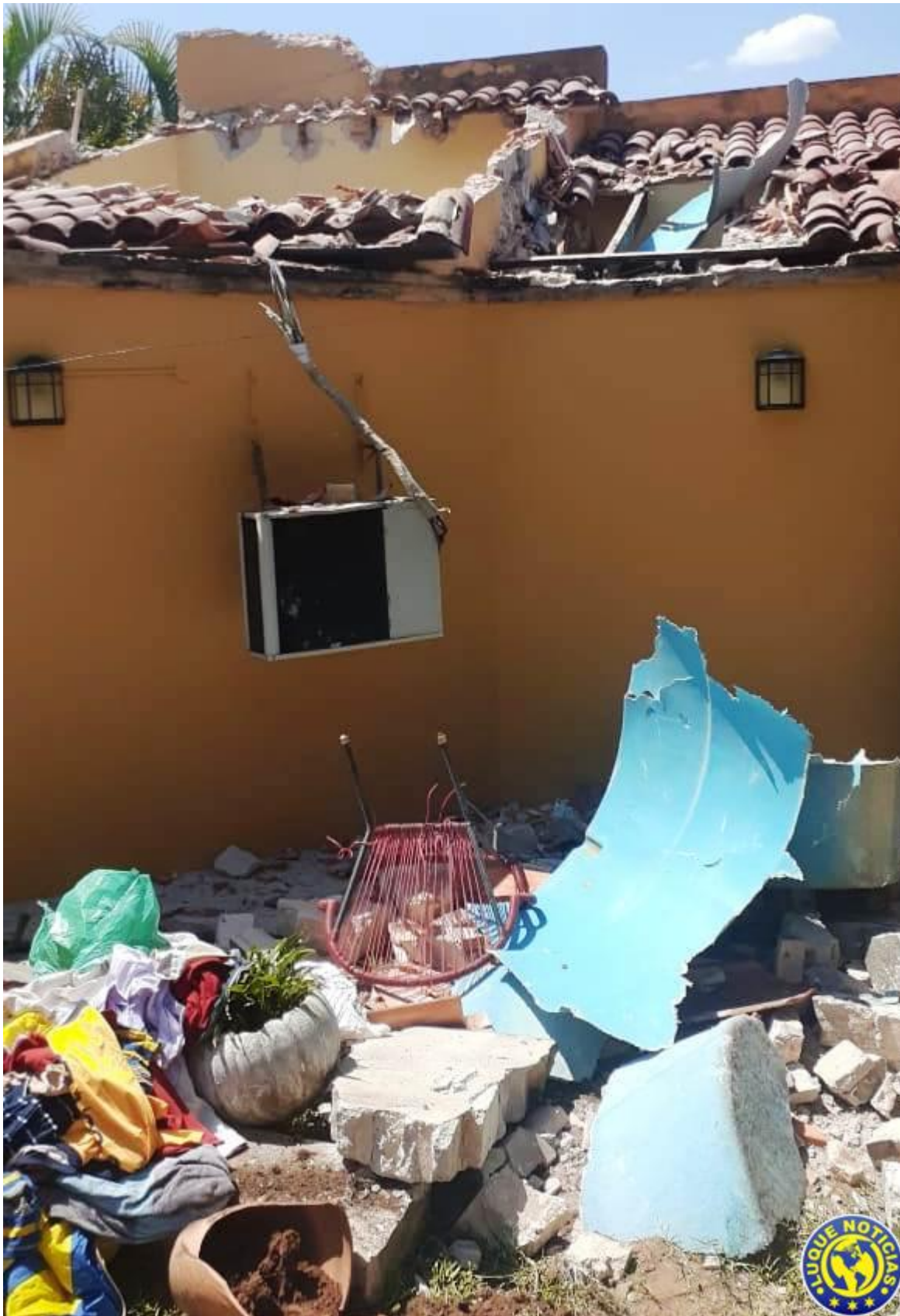
Así quedó la casa tras el derrumbe. La víctima fue rescatada debajo de los escombros.
