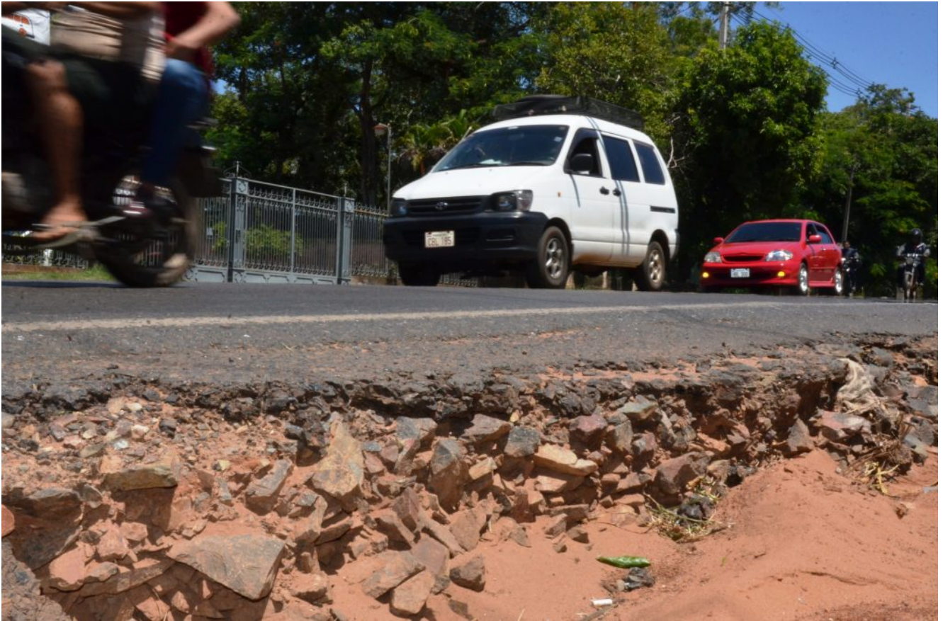
El pozo afecta parte del asfaltado.
